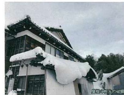
屋根の軒先の破損
